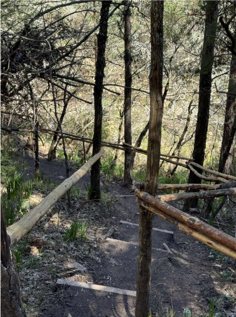
Pasamanos y peldaños a retirar
