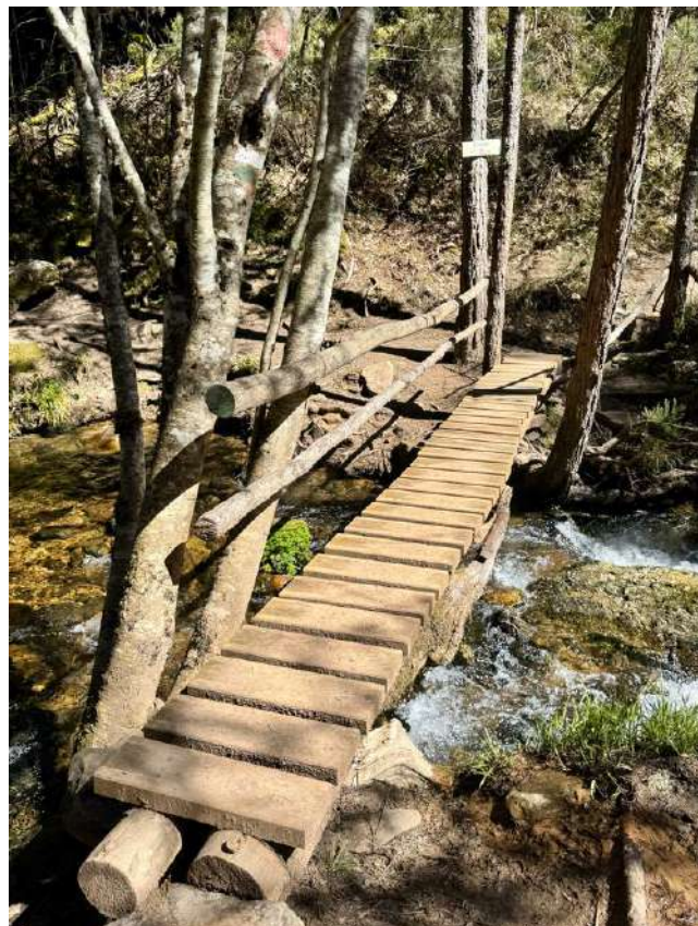
Retirada y sustitución de la pasarela actual de la Cascada de Peñoncito
